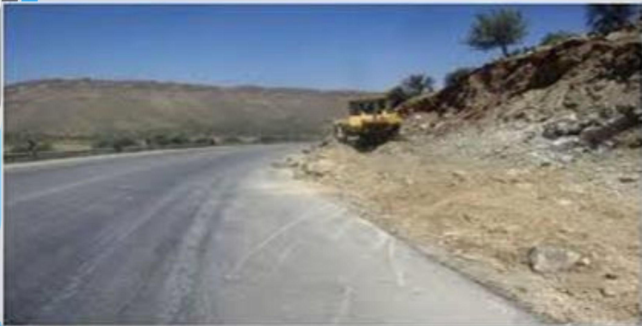
شکل ۱۳: نقطه حادثه خیز بین روستایی بدون خط کشی، تابلو و روشنایی
